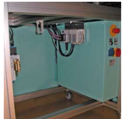
Schaltschrank und Ventilinsel
